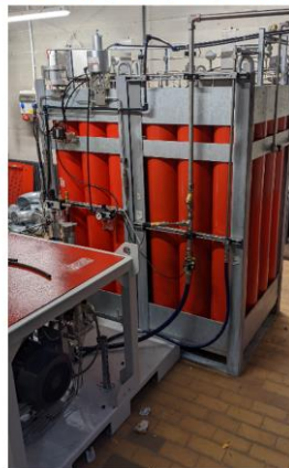
Wasserstoffverdichter und -Speicher Compresseur d'hydrogène & stockage d'hydrogène
