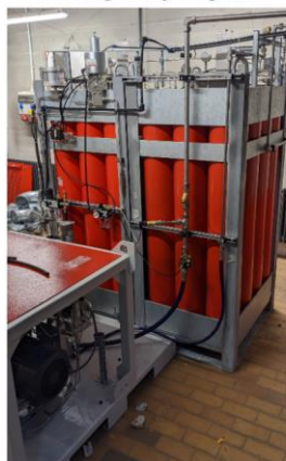
Compresseur d'hydrogène & stockage d'hydrogène
