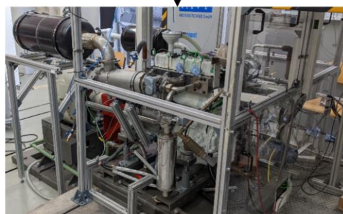
Cogénérateur à moteur à gaz
